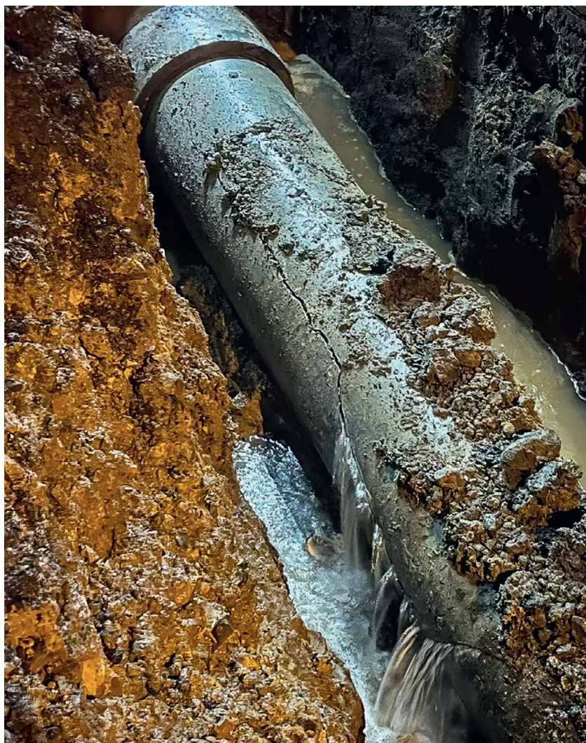
ÉTAT D'UNE CONDUITE D'EAU DE 70 ANS
